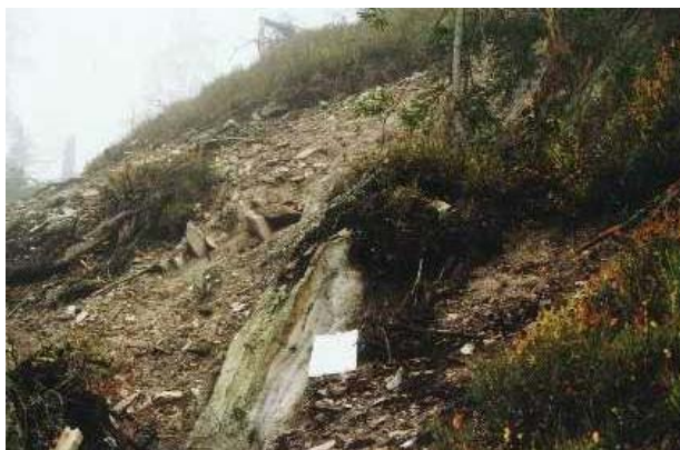
Obr. 5.2.7 Na veľmi strmých svahoch budovaných štrkopieskovými svahovými sedimentmi sa vegetácia nezachytala ani po vyše troch rokoch.
