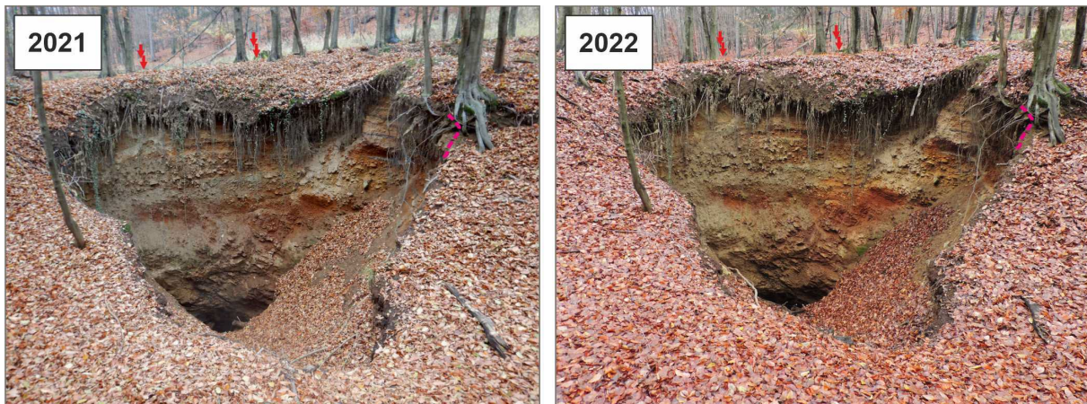
Obr. 4.4.4: Porovnávacie fotografické snímkovanie závalu Z1 nad banskou chodbou štôlne Rýhová z r. 2021 a 2022 (pohľad z juhu) s označením situovania monitorovacích kolíkov (červenými šípkami) a vyznačením jeho nepatrného rozširovania iba v pripovrchovej zóne
