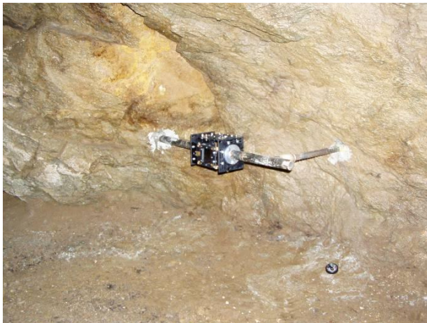
Obr. 32 Inštalácia dilatometra TM-71 v opustenej štôlni sv. Anton Paduánsky na lokalite Vyhne
