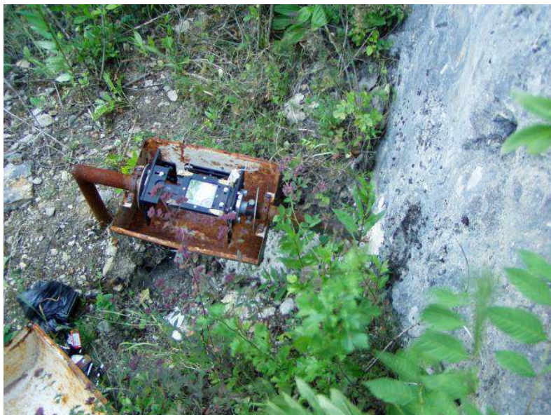
Obr. 23 Inštalácia dilatometra TM-71 na tektonickej poruche na lokalite Dobrá Voda
