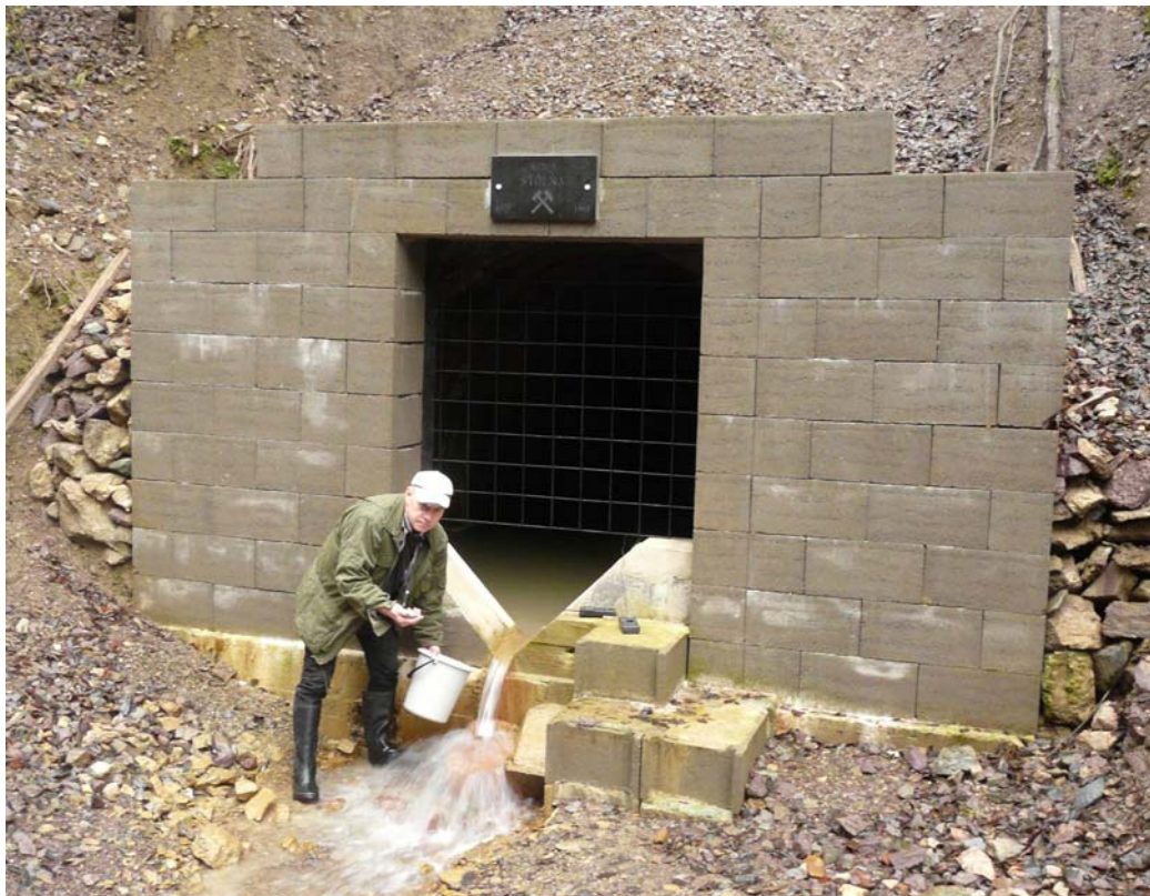
Ústie Novej s upraveným portálom po poslednom prievale. (foto P. Bajtoš, 8.12.2009)
