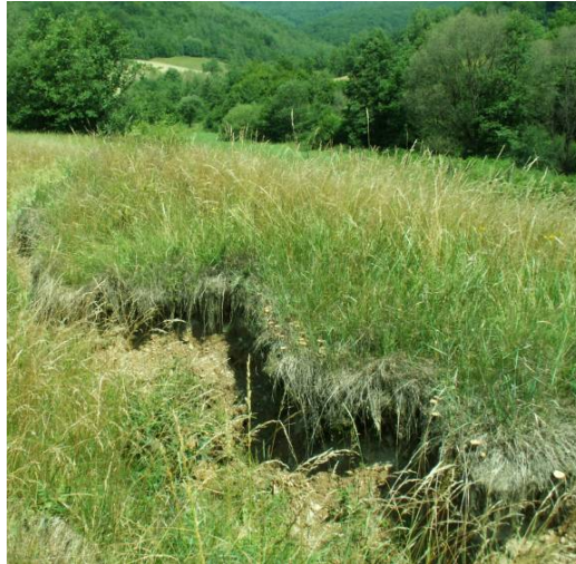
Ťahové trhliny pozdĺž východného okraja závalu 15, 18, 14 (foto Záhorová, 2009)
