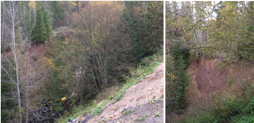
Zával je zaplňovaný odpadom rôzneho druhu, jeho okraje sa zosúvajú (foto Záhorová, 2007)
