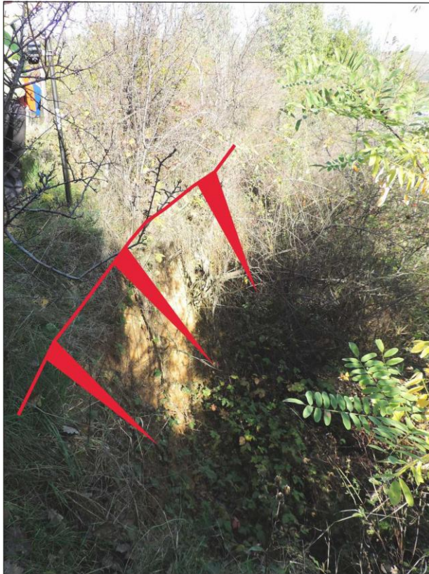
Obr. 4.12.4: Pohľad na aktivizovanú trhlínu t5.
