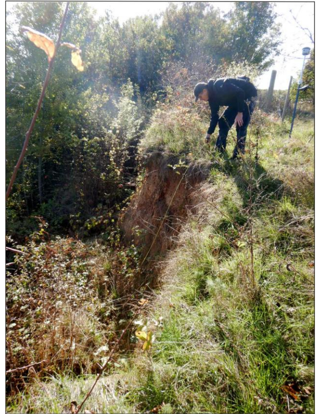
Obr. 4.12.5: Aktivizovaná trhlina t9.
