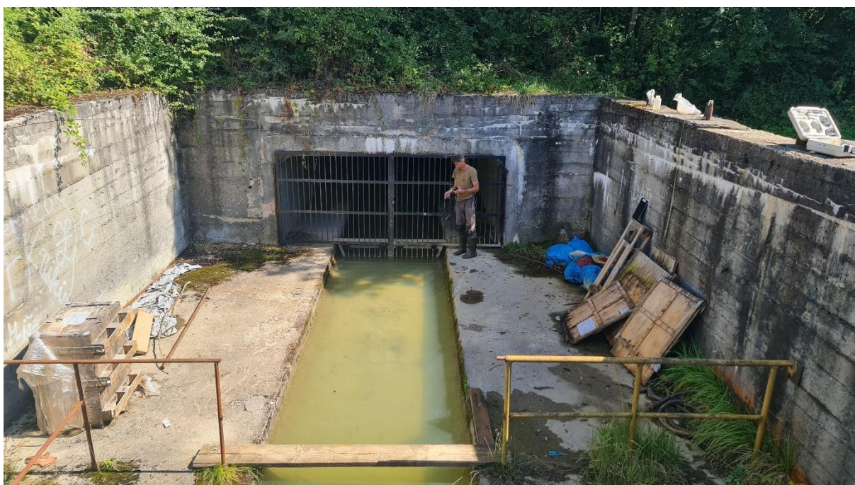
Obr. 4.1.3: Ústie NOŠ so vzdutou hladinou odtekajúcej banskej vody spôsobujúcou zvýšené usadzovanie kalu.
