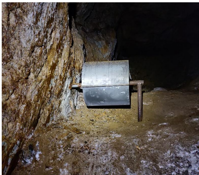
Obr. 38 Inštalácia dilatometra TM-71 v štôlni Starovšechsvätých na lokalite Banská Hodruša
