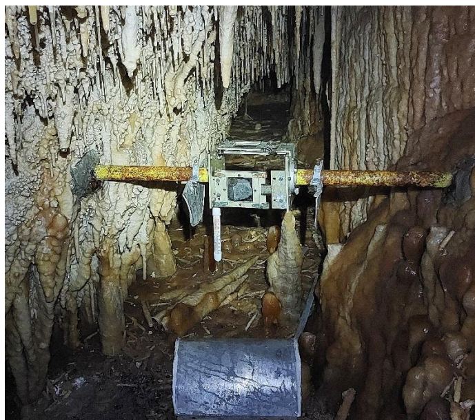
Obr. 36 Inštalácia dilatometra TM-71 v Čarovnej chodbe (Demänovská jaskyňa Slobody)
