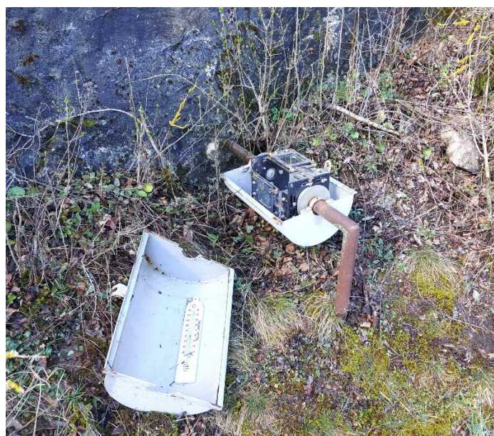
Obr. 40 Inštalácia dilatometra TM-71 na lokalite Dobrá Voda
