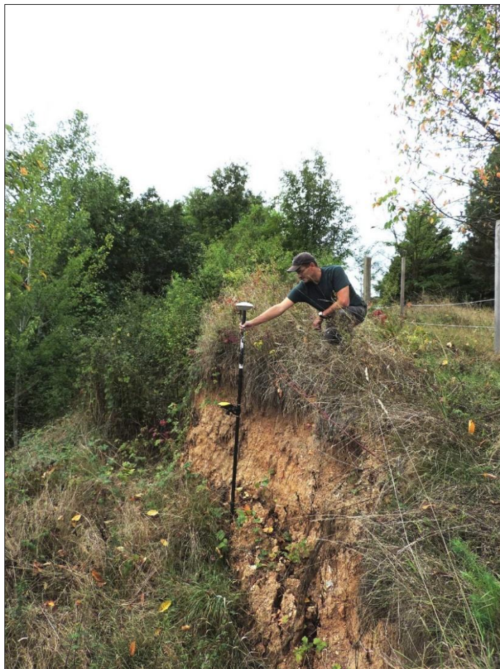
Obr. 4.12.5: Pohľad na aktivizovanú trhlínu t5
