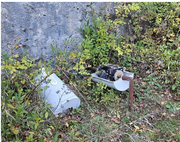
Obr. 39 Inštalácia dilatometra TM-71 na tektonickej poruche na lokalite Dobrá Voda
