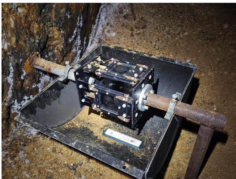
Obr. 37 Inštalácia dilatometra TM-71 v štôlni Starovšechsvätých na lokalite Banská Hodruša
