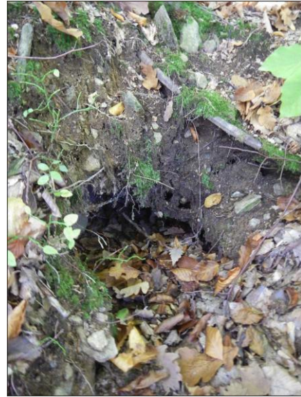
Obr. 4.7.11 Otvor v trhlíne 24b
