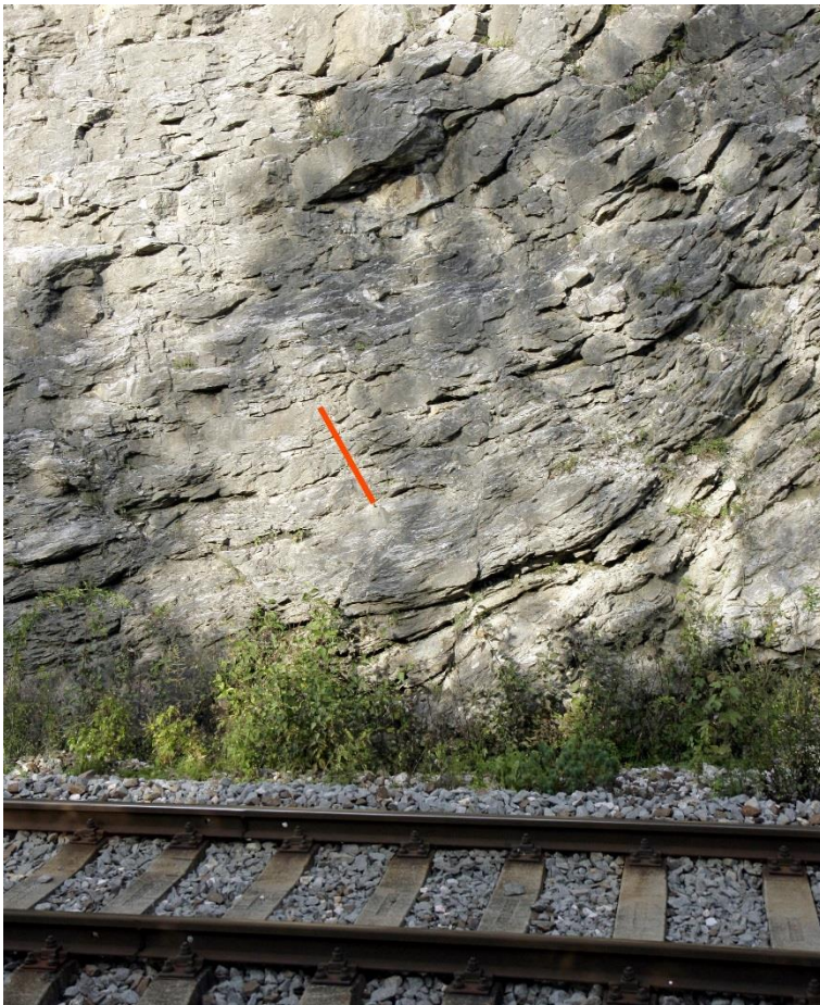
Obr. 4.20.1. Umiestnenie stanoviska na meranie mikromorfologických zmien povrchu odkrytého zárezu železnice pri obci Jakub. Červenou líniou je zvýraznené stanovište umiestnenia meradla morfologických zmien.
