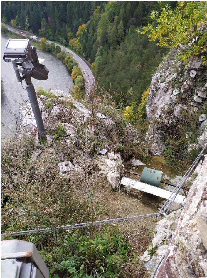
Obr. 22 Pozícia dilatometra TM-71 v trhline pod kaplnkou Strečnianskeho hradu.
