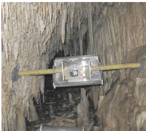
Obr. 29 Inštalácia dilatometra TM-71 v Čarovnej chodbe (Demänovská jaskyňa Slobody)
