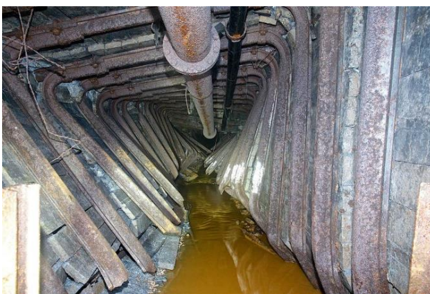
Obr. 43: Deformácie výstuže banskej chodby
