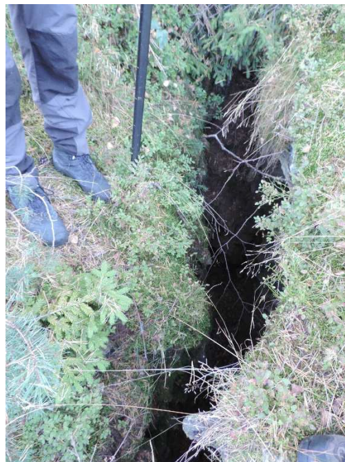
Obr. 34: Trhlina nad zosuvom ZH3
