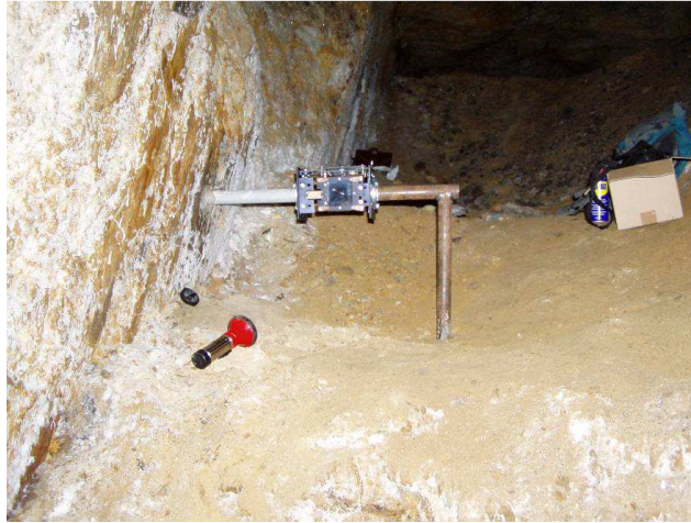
Obr. 20 Inštalácia dilatometra TM-71 v opustenej štôlni Všetechsvätých (stará) na lokalite Banská Hodruša (Hámre)
