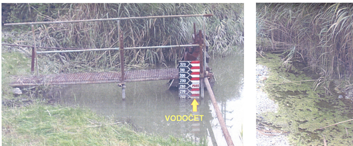
Obr.4.3 Pohľad na vodočet a zamokrenú päť vzdušného svahu hrádze, 2006 (prevzaté z [2])
