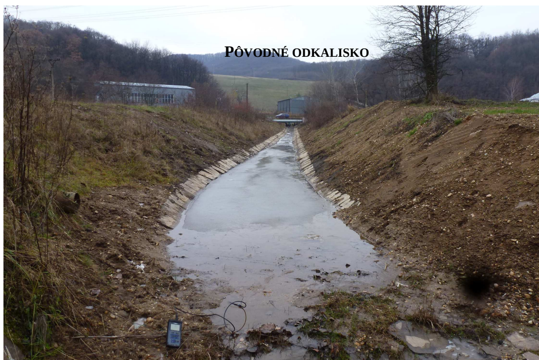
Obr. 17 Vyústenie drenáže pod Pôvodným odkaliskom – odberové miesto vzorky ZK-3.
