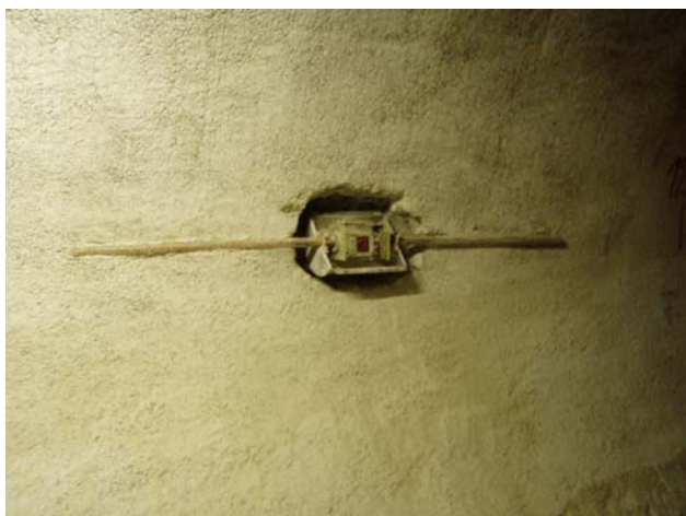
Obr. 2.2.2: Inštalácia dilatometra TM-71 v únikovej štôlni tunela Branisko
