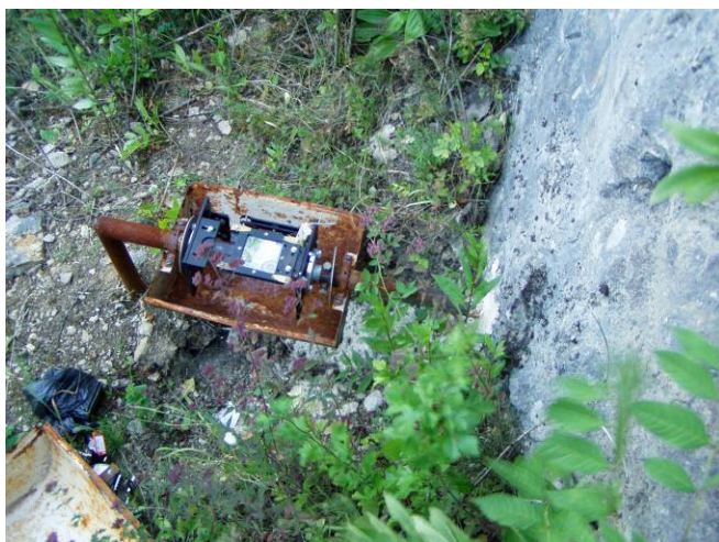
Obr. 2.2.7: Inštalácia dilatometra TM-71 na tektonickej poruche na lokalite Dobrá Voda
