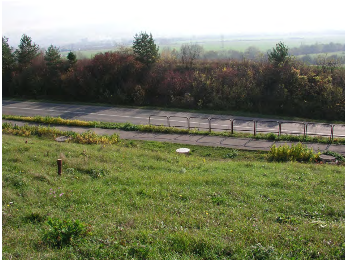
Obr. 2.1.81: Pohľad na časť zosuvného svahu na južnom okraji Bojníc a kontakt zosuvu so štátnou cestou vedúcou do Opatoviec nad Nitrou (foto P. Ondrejka, 2006)
