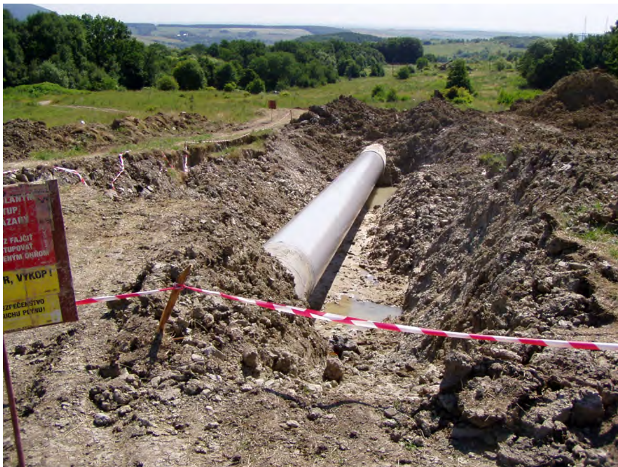
Obr. 2.1.47: Celkový pohľad na zosuvný svah pri Slanci. V popredí údržba jednej z vetiev tranzitného plynovodu (foto Ľ. Petro, 2007)
