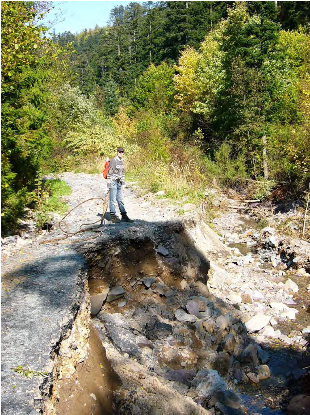
Obr. 100: Teplá ka nad Hornádom o následky prievahu banskej vody z Novej Ľôľne. Erózia pôvodného koryta potoka pod Ľôľou a de-trukcia vozovky. Foto: P. Baláfi, 2.10.2008.
