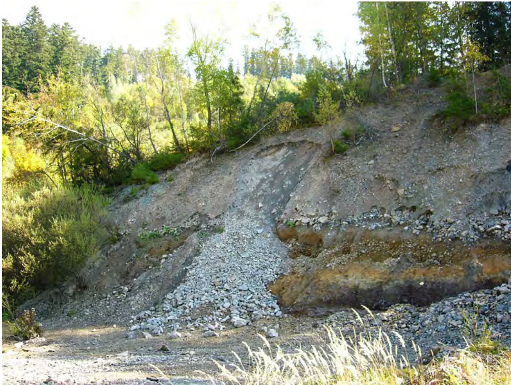
Obr. 101: Teplá ka nad Hornádom o následky prievalu banskej vody z Novej Ťolne. Erózia haldy lokalizovanej pod Ťolnou. Foto: P. Baláfi, 2.10.2008.
