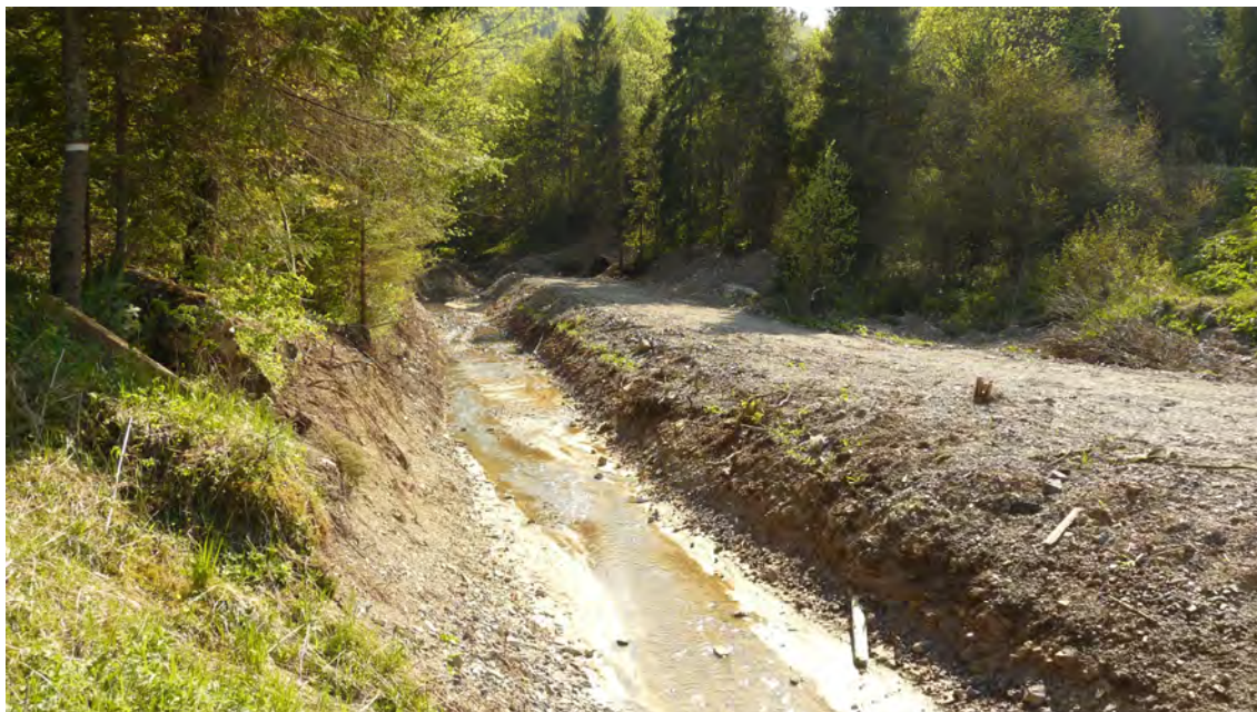
Obr. 107: Teplá ka nad Hornádom o následky prevalu banskej vody z Novej Ťolne. Ústie Novej Ťolne a odtokové koryto po rekonštrukčných prácach. Foto: P. Bajto, 3.5.2009.
