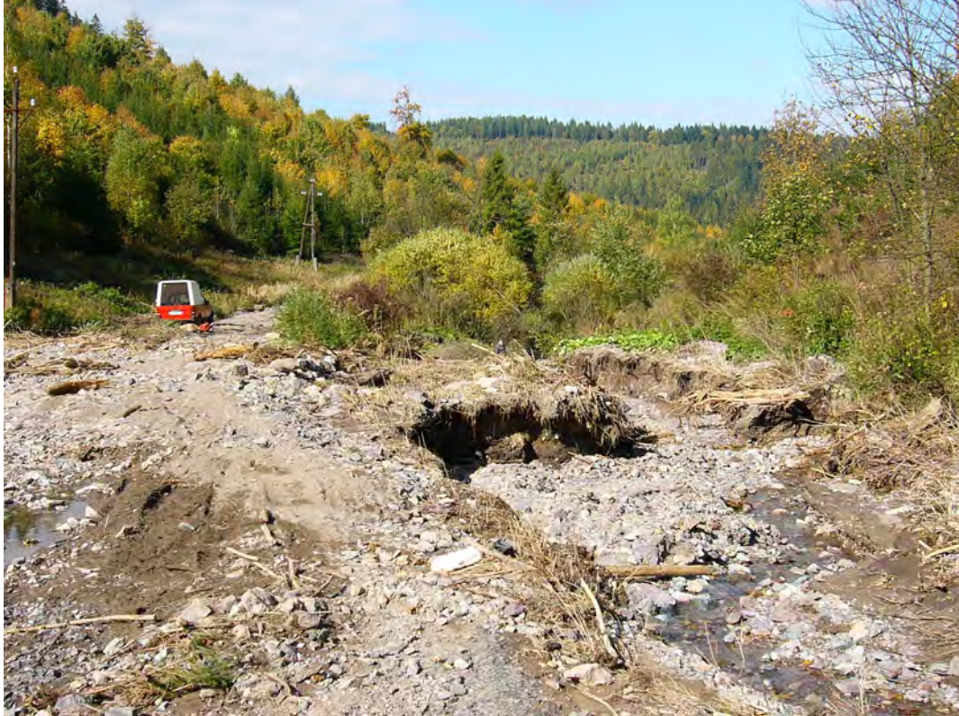
Obr. 105: Teplá nad Hornádom o následky prievalu banskej vody z Novej Hôrky. Erózia pôvodného koryta potoka pod Hôrkou a deštrukcia vozovky. Foto: P. Baláž, 2.10.2008.
