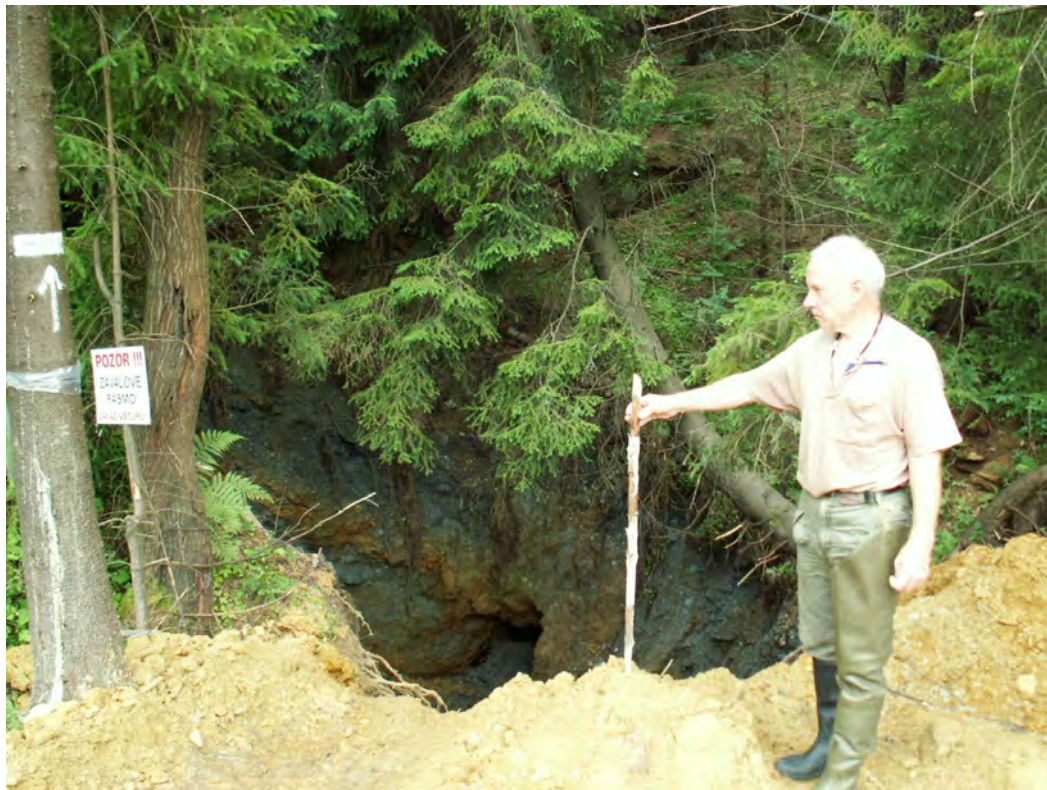
Obr. 68: Lokalita Smolník. Nový zával pri ceste nad odkaliskom - komín h bky vy-e 4 m s ústím 3,5x3 m. Foto: P. Bajto-, 30.6.2008.
