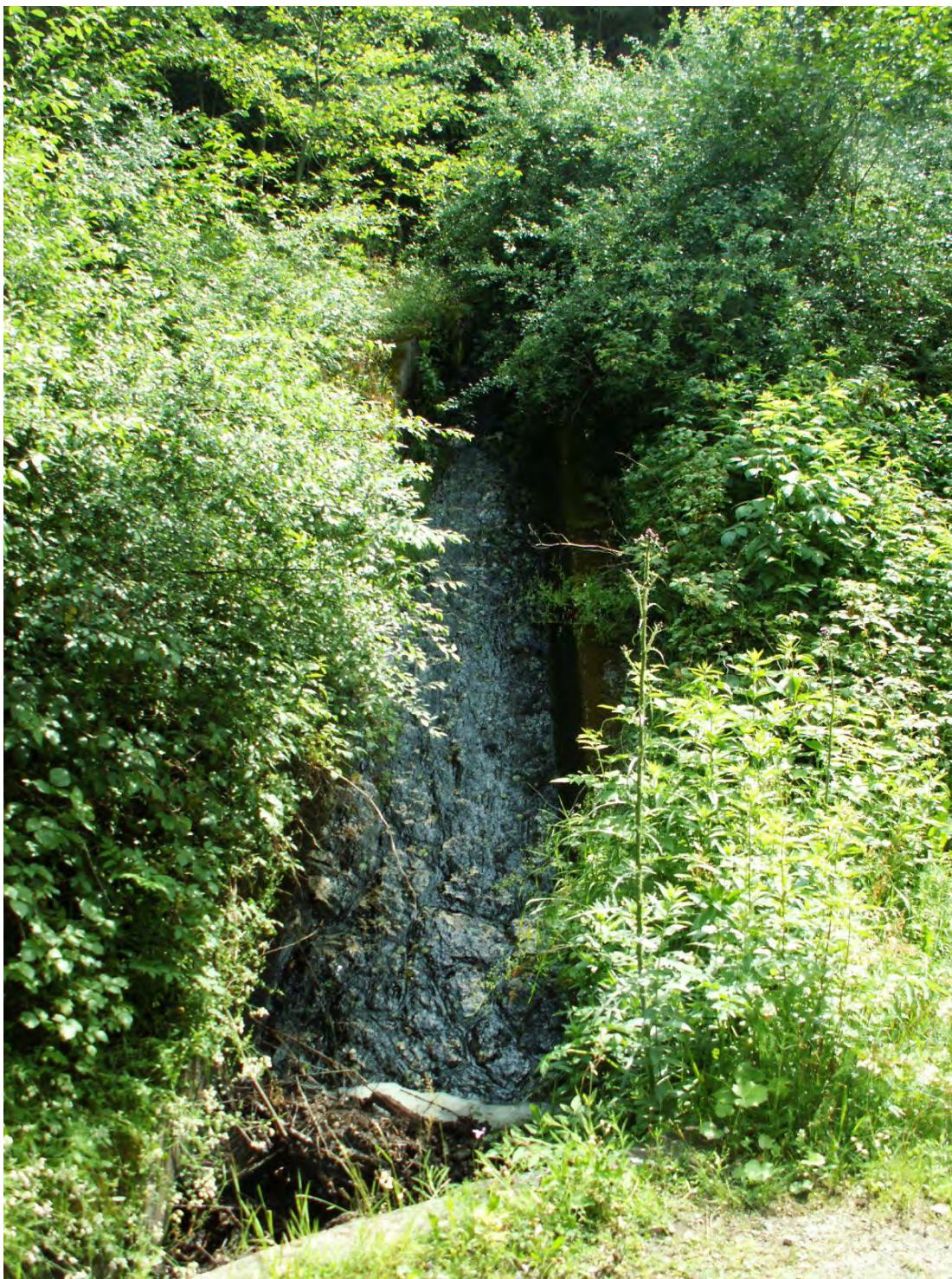
Obr. 46: Lokalita Slovinky. Priesak spod odkaliska .3 zvedený betónovým fl abom so strmým spádom do hlavného odvod ovacieho rigolu. Foto: P. Bajto-, 26.6.2008
