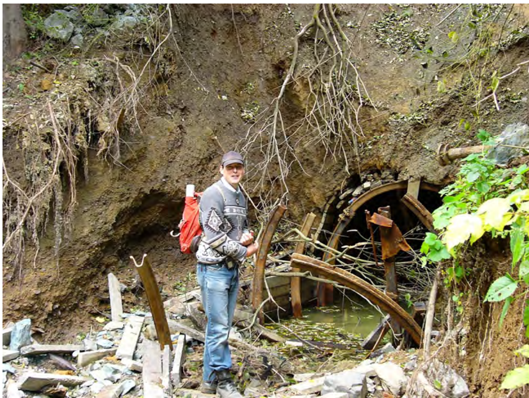
Obr. 98: Teplička nad Hornádom ō následky prievahu banskej vody z Novej ōtŕne. De-trukcia portálu v ústí ōtŕne. Foto: P. Baláfi, 2.10.2008.
