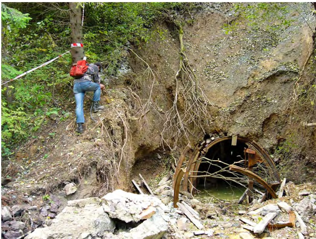
Obr. 97: Teplička nad Hornádom ō následky prievahu banskej vody z Novej ōtŕne. De-trukcia portálu v ústí ōtŕne. Foto: P. Baláfi, 2.10.2008.
