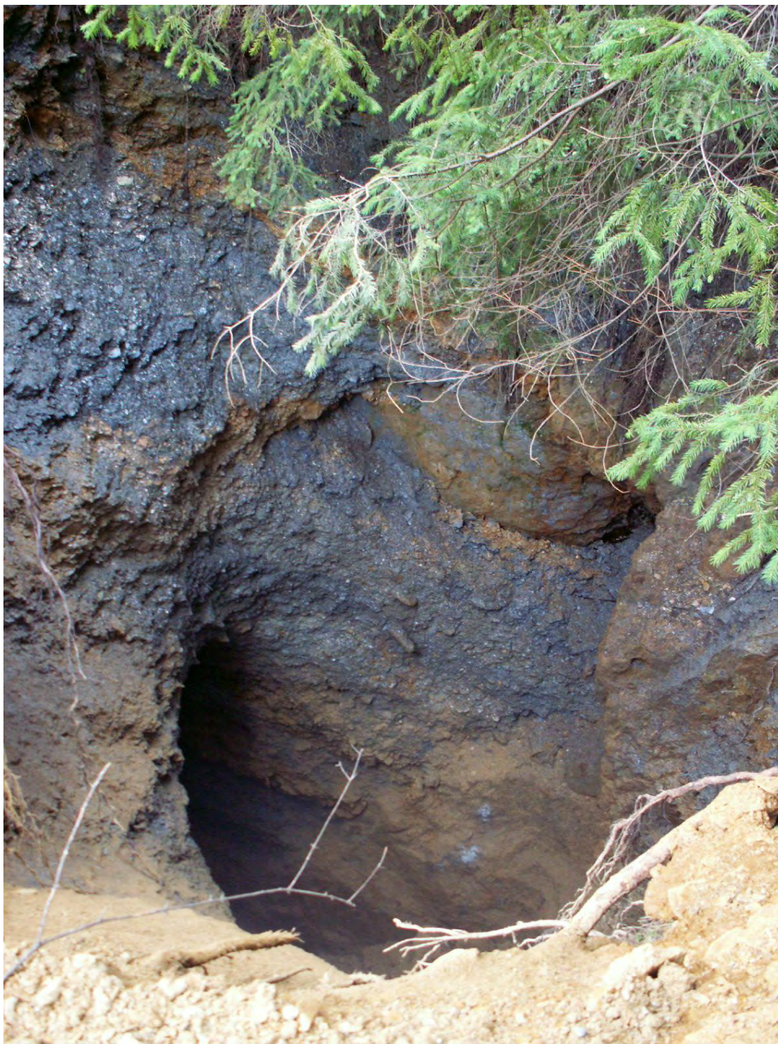
Obr. 66: Lokalita Smolník. Nový zával pri ceste nad odkaliskom - komín h bky vy-e 4 m s ústím 3,5x3 m. Foto: P. Bajto-, 30.6.2008.
