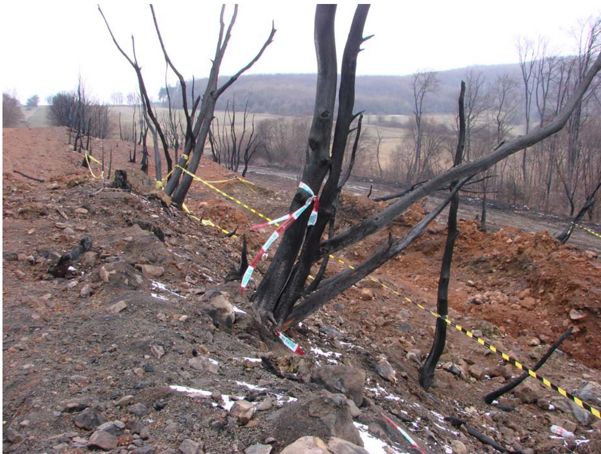
Obr. 2.1.26: Miesto havárie medzištátneho vysokotlakového plynovodu nachádzajúce sa pri západnom okraji monitorovaného zosuvného územia Slanec – TP, ku ktorej došlo dňa 17. marca 2008
