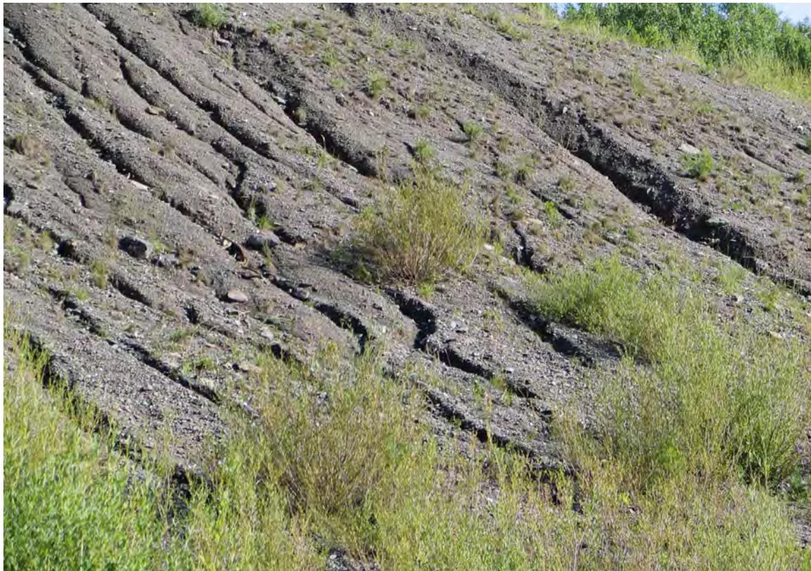
Foto č. 6: Erózia svahu haldy.
