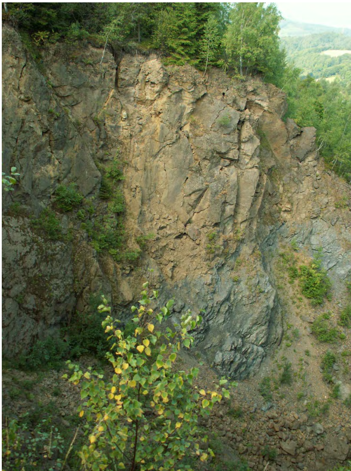
Foto č. 3: Ťahovo-poklesové trhliny - aktívne
