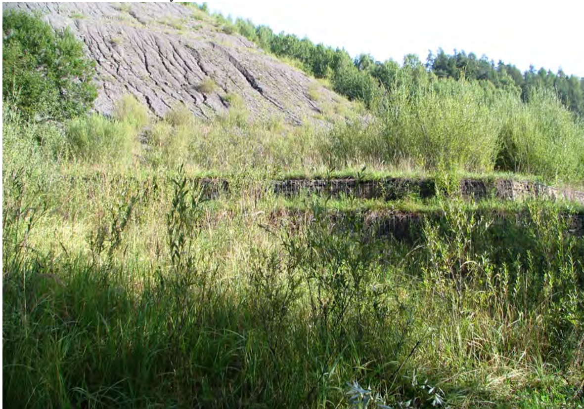
Foto č. 7: Päta haldy je stabilizovaná, ale povrch haldy nie je rekultivovaný dostatočným vegetačným pokryvom.
