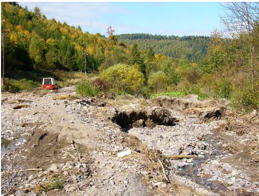
Obr. 105: Teplička nad Hornádom – následky prievalu banskej vody z Novej štólne. Erózia pôvodného koryta potoka pod štôľňou a deštrukcia vozovky. Foto: P. Baláž, 2.10.2008
