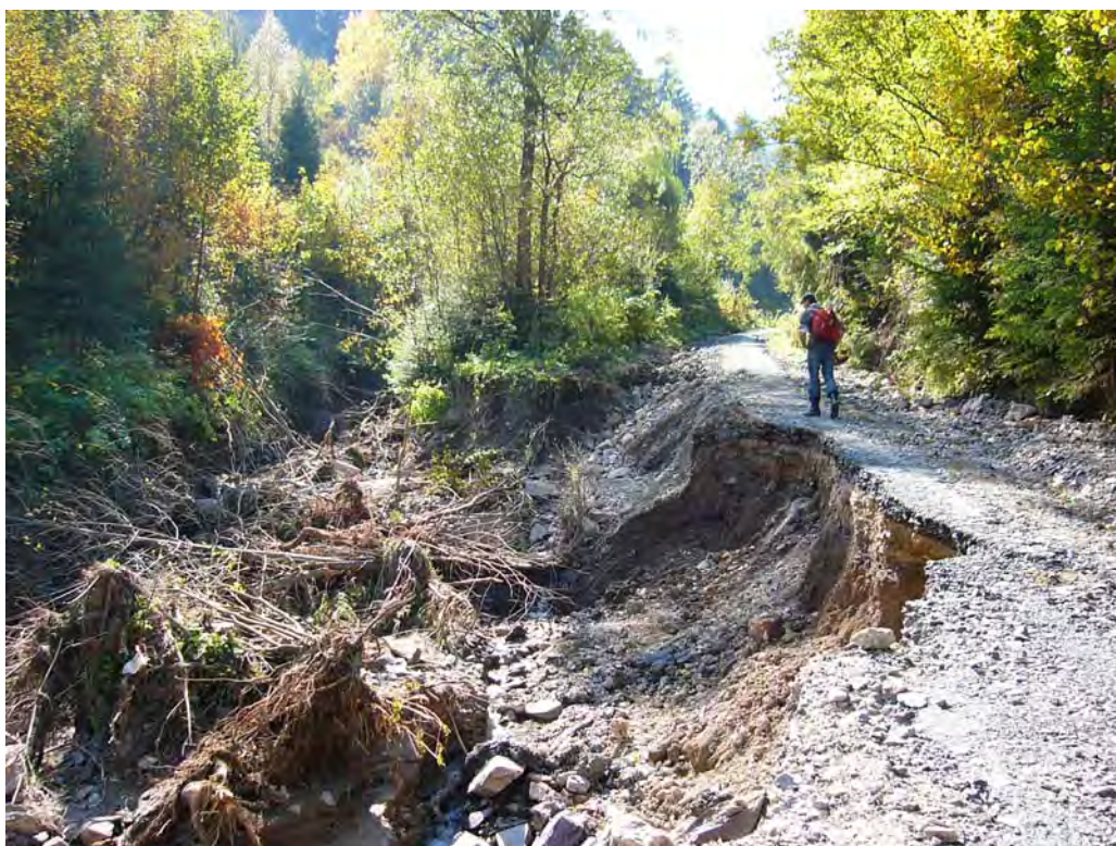
Obr. 104: Teplička nad Hornádom – následky prievalu banskej vody z Novej štôlne. Erózia pôvodného koryta potoka pod štôľňou a deštrukcia vozovky. Foto: P. Baláž, 2.10.2008
