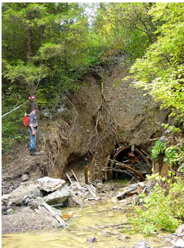
Obr. 2.4.78: Ústie Novej štôlny po prvom prievale banskej vody. (foto P. Baláž, 2.10.2008)
