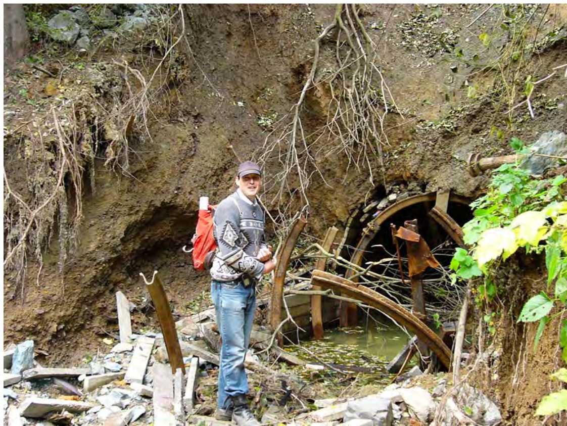
Obr. 98: Teplička nad Hornádom – následky prievalu banskej vody z Novej štólne. Deštrukcia portálu v ústí štólne. Foto: P. Baláž, 2.10.2008
