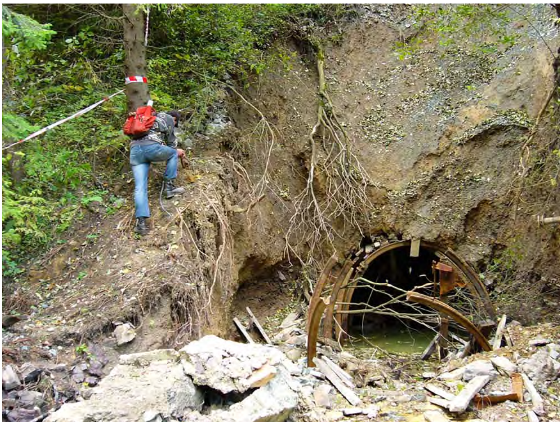
Obr. 97: Teplička nad Hornádom – následky prievalu banskej vody z Novej štólne. Deštrukcia portálu v ústí štólne. Foto: P. Baláž, 2.10.2008
