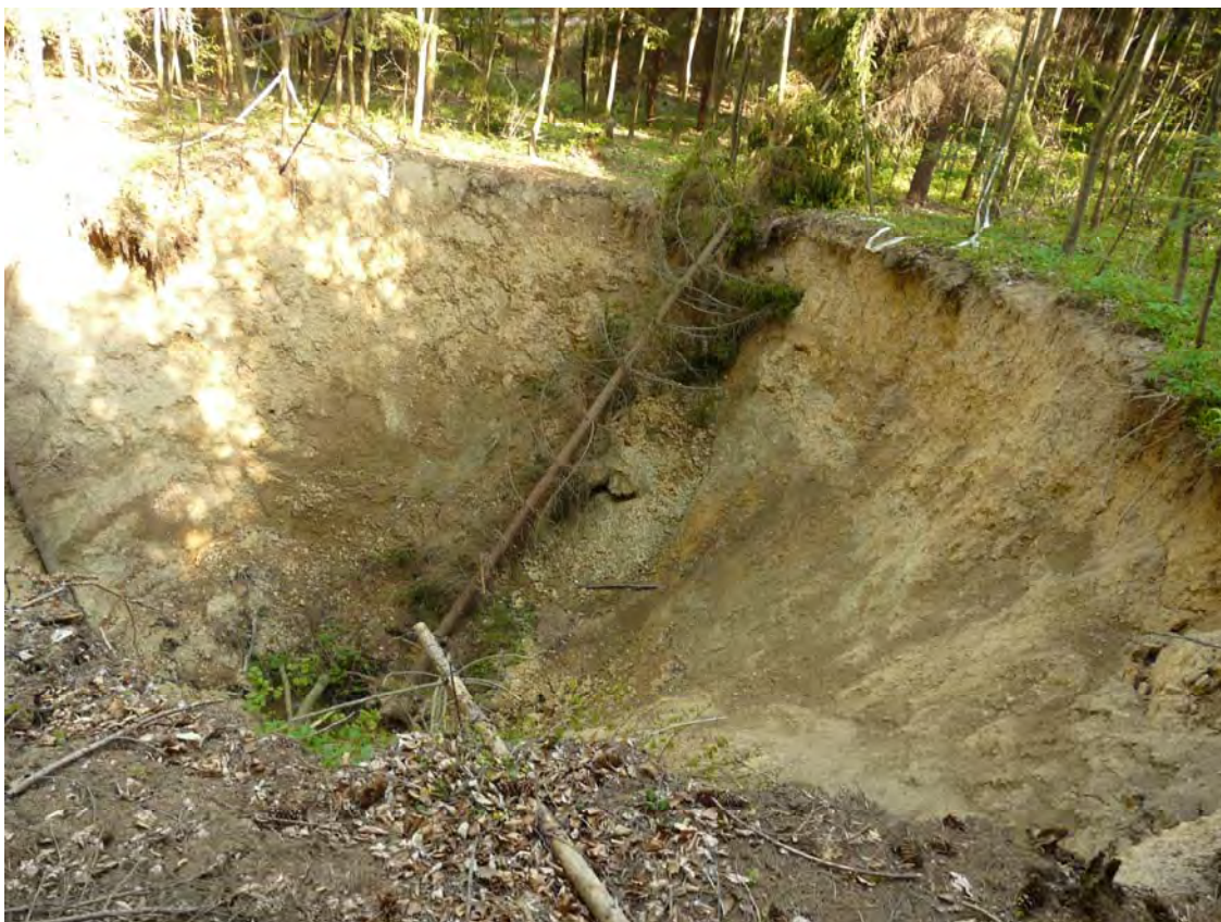
Obr. 109: Teplička nad Hornádom – následky prievahu banskej vody z Novej štôlne. Kráterovitý zával nad Novou štôľňou – pohľad zo Z. Priemer krátera 15 m, hĺbka 8-10 m. Foto: P. Bajtoš, 3.5.2009
