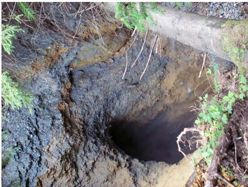
Obr. 67: Lokalita Smolník. Nový zával pri ceste nad odkaliskom - komín hĺbky vyše 4 m s ústím 3,5x3 m. Foto: P. Bajtoš, 30.6.2008
