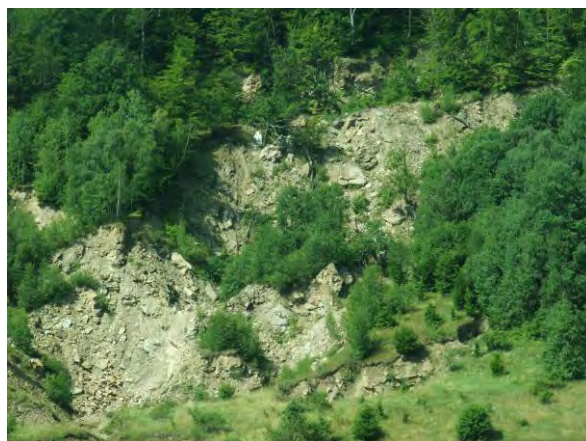
Obr. 2.4.47: Centrálne časť poruchového pásma (závaly 4, 5, 6) (foto Záhorová, 2009)
