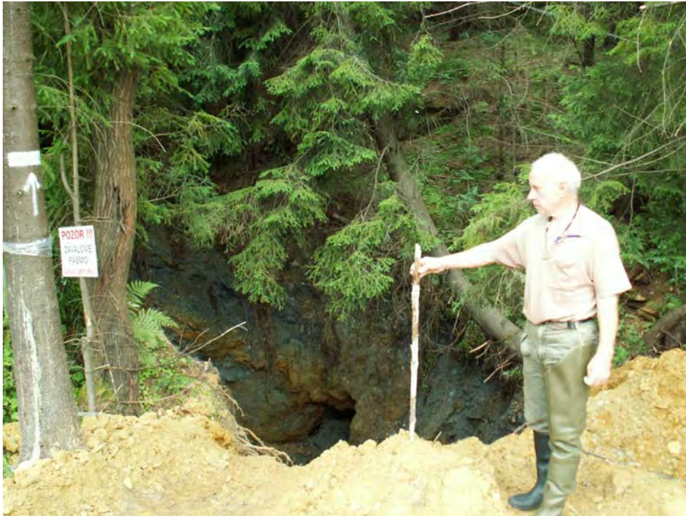
Obr. 68: Lokalita Smolník. Nový zával pri ceste nad odkaliskom - komín hĺbky vyše 4 m s ústím 3,5x3 m. Foto: P. Bajtoš, 30.6.2008
