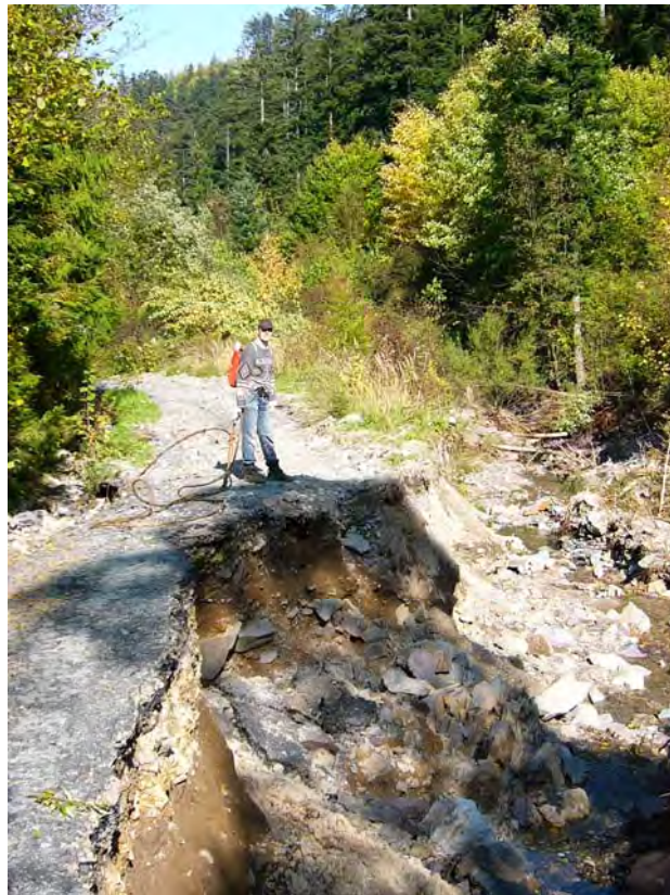
Obr. 100: Teplička nad Hornádom – následky prievalu banskej vody z Novej štôlne. Erózia pôvodného koryta potoka pod štôľňou a deštrukcia vozovky. Foto: P. Baláž, 2.10.2008
