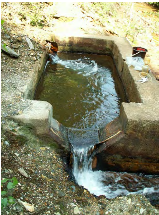
Obr. 56: Lokalita Smolník. Detail merného objektu banskej vody šachty Pech. Foto: P. Bajtoš, 30.6.2008
