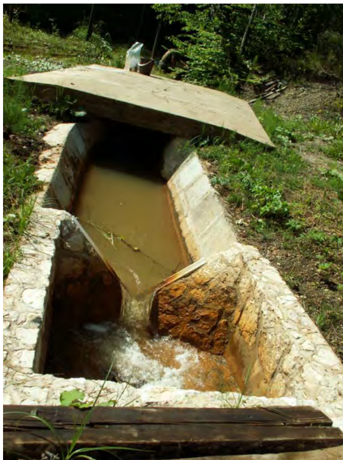
Obr. 41: Lokalita Slovinky. Merný objekt na výtoku banskej vody zo štólne Alžbeta v Slovinkách. Foto: P. Bajtoš, 26.6.2008
